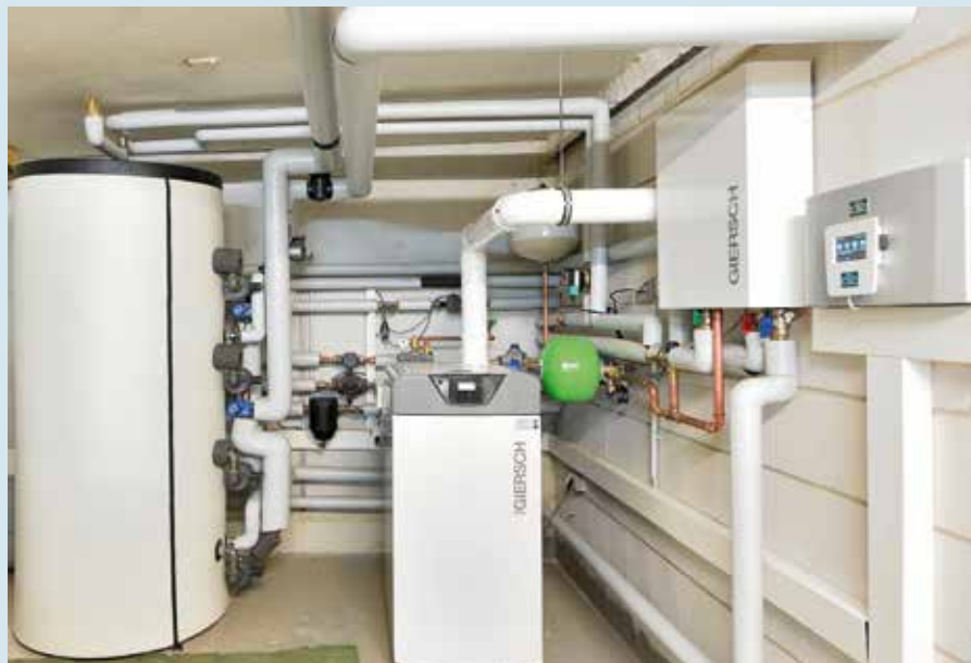
Hybridkomponenten I: 1.000-Liter-Pufferspeicher, (Giega-Therm), Öl-Brennwertgerät FCU 30-M und CTC-Steuerung im Heizraum.
