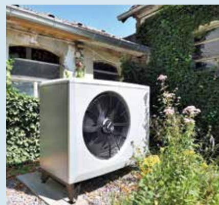
Hybridkomponente II: Die Luft-Wasser-Wärmepumpe Eco Air 520M ist im Außenbereich vor dem Heizraum platziert.
